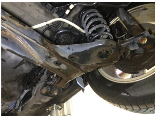
1.1 Overflaterust i bakstilling, ingen tiltak kreves
