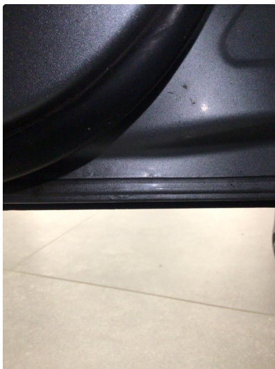
1.2 Noe korrosjon i fals og på innsiden av begge framdører
