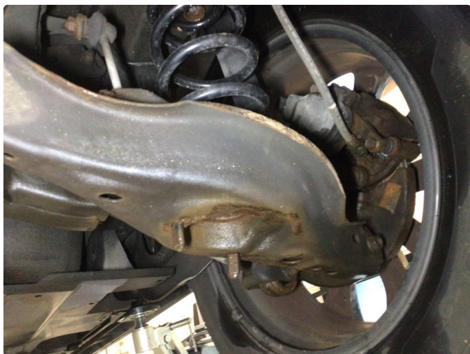
2.2 Overflaterust i bakstilling, ingen tiltak kreves
