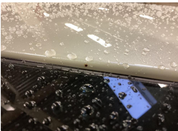
1.5 Liten steinsprut med rust på tak
