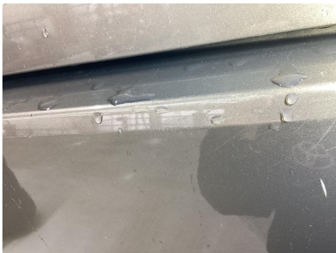
1.5 Ripe(r). UTBEDRINGER UTFØRT PÅ KLARGJØRINGEN.
