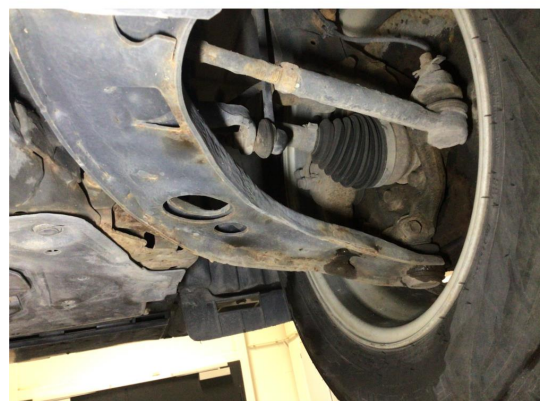
2.1 Overflaterust i forstilling, ingen tiltak kreves
