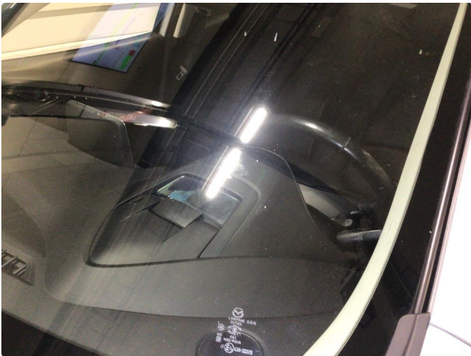
1.4 Noe steinsprut på frontvindu
