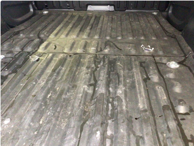
1.1 Noe rifter i gulvbekledning i varerom
