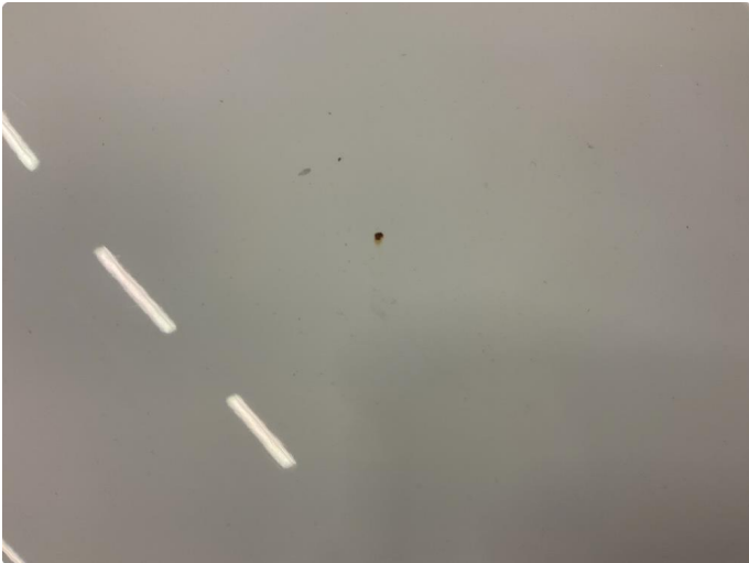
1.1 Noe steinsprut med rust
