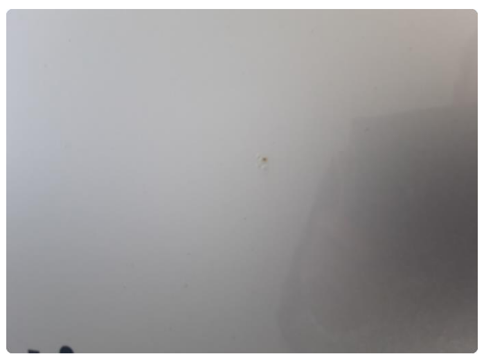
1.4 Liten stensprut med korrosjon på høyre skyvedør.
