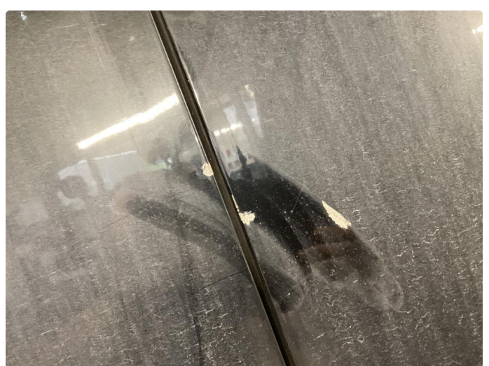
1.1 Lakk flasser- Utbedret!
