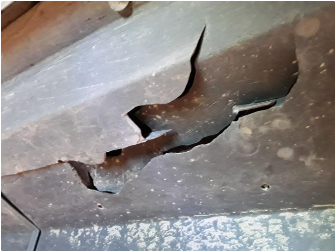
1.1 Noe skadet deksel under vogn.
