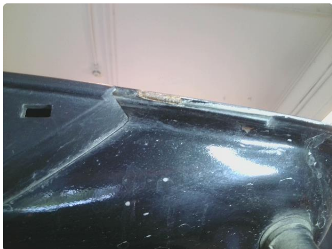
2.7 Steinsprut med rust
