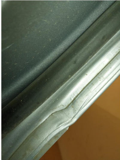
2.2 Korrosjon i fals
