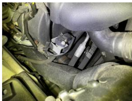
24. Utvendig tilstand motor
