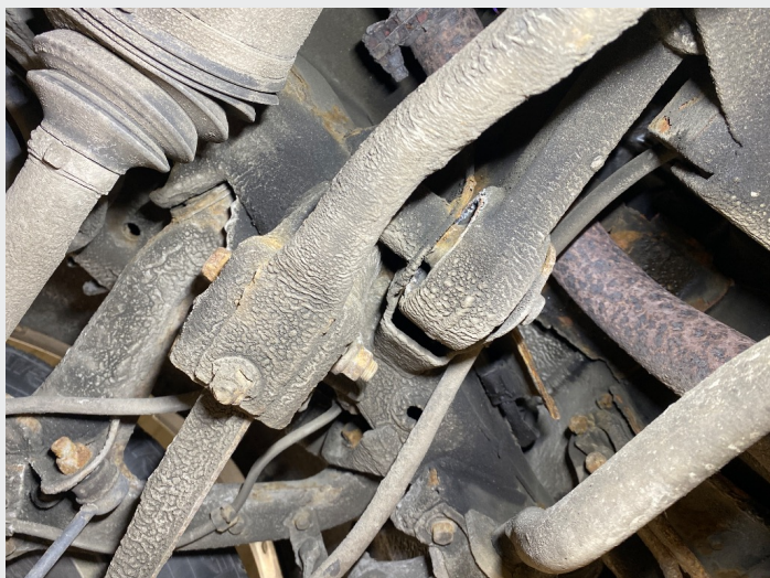
2.2 Rust under bil
