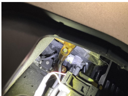
1. Varmeapparat / klimaanlegg (AC)
