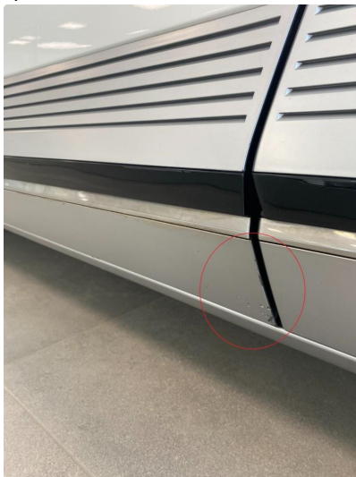
1.2 Nedre del dør v.f små hakk i plastikk
