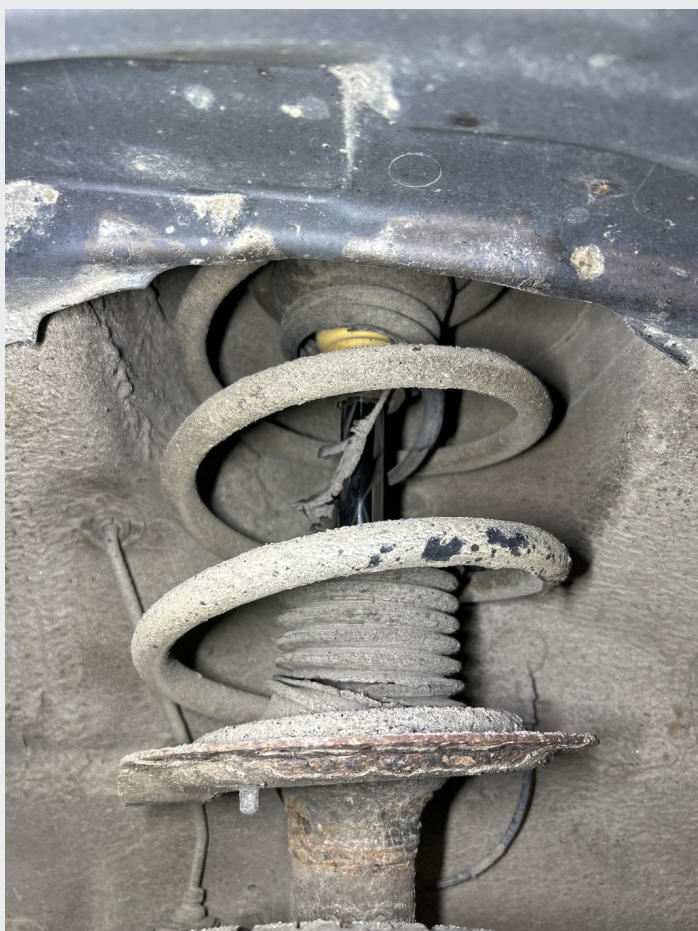
8.6 Revnet mansjett på begge støtdempere foran
