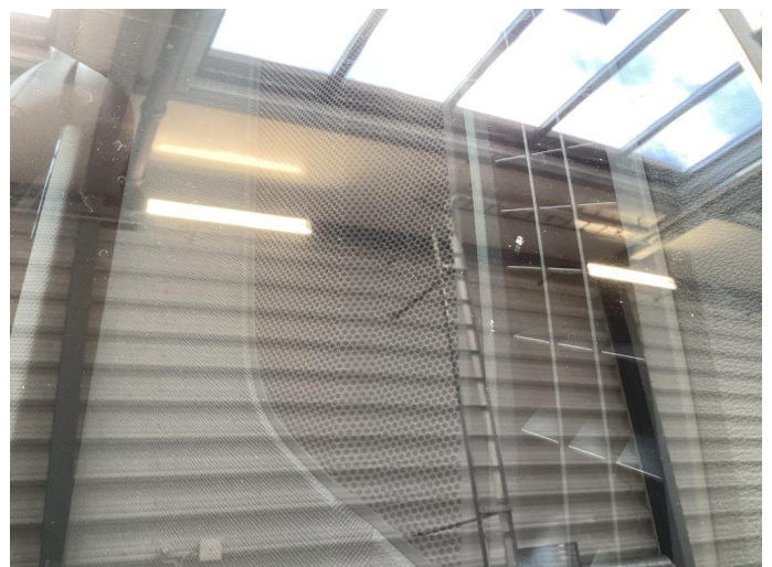
1.4 Noe steinsprut frontrute
