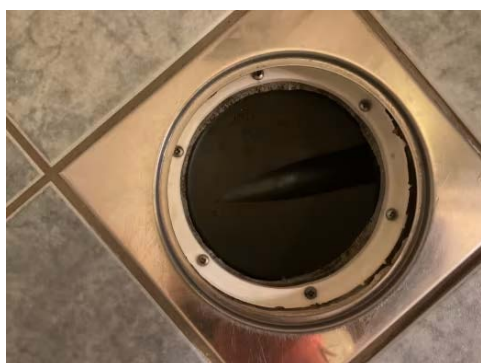
Sluk bad 2 etg
