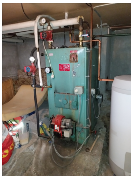
Fyrkjeler/bereder med ekstern/tilleggsmontert ekspansjonstank og sirkulasjonspumpe.
