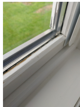
Enkelte vinduer med fuktmerker etter kondens.
