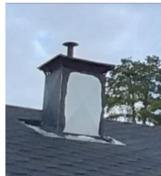
Avtrekkshette med avflassinger.
