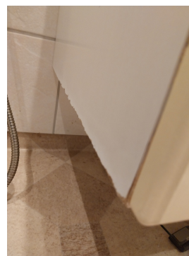
Påvist svellinger i nedkant benkeskrog servantinnredning.
