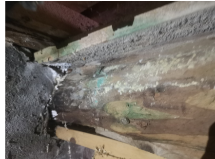
Bærebjelke i tak, med råte.
