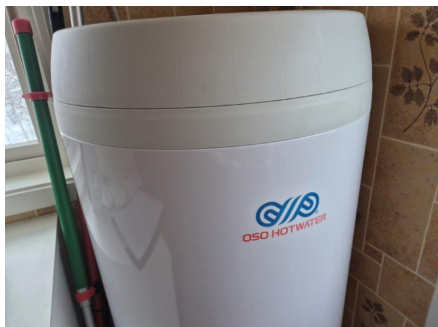
Varmvannsbereider i vaskerom.
