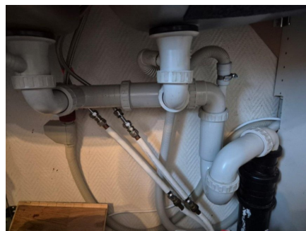
Røropplegg i kjøkkenbenk.
