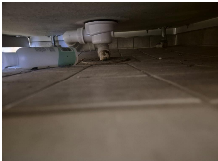
Sluk under dusjkabinett.
