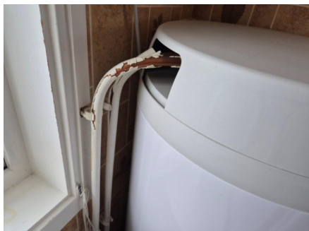
Innvendige vannledninger av kobber.
