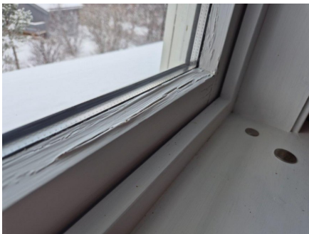
Oppsprekking av maling i vinduskarm.
