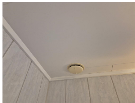
Ventil i innvendig tak.
