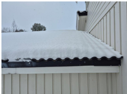
Betongtakstein over utebod.
