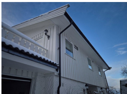
Takrenner og nedløpsrør i stål.
