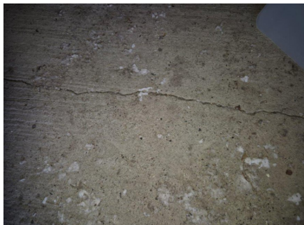
Sprekkdannelse i betonggulv i garasje.
