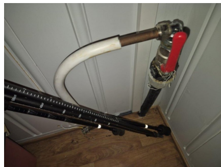
Innvendig stoppekran i bod i underetasjen.
