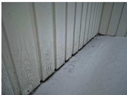
Oppsruknet og noe begynnende råteskade i utvendig panel i utebod over garasje.
