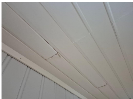
Mindre skade i malt himlingspanel i hall i underetasjen.
