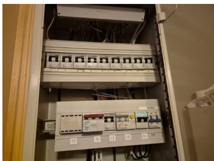
Sikringsskap med automatsikringer.
