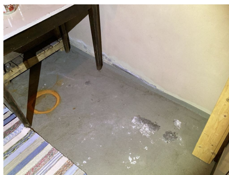
Saltutslag på innvendig gulv
