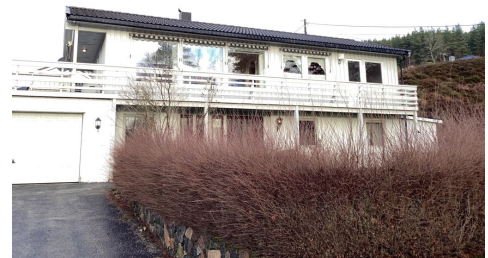
Taket har ikke snøfangere
