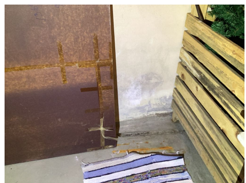
Saltutslag på vegg
