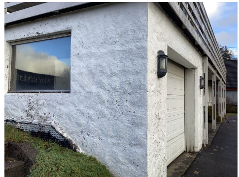
Sprekk i grunnmur på garasje
