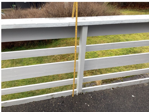
Rekkverk er lavere enn dagens krav
