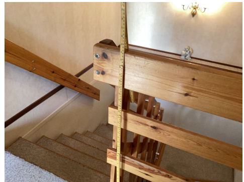
Rekkverk lavere enn dagens krav.
