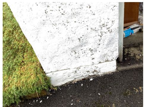
Sprekk mellom grunnmur og såle
