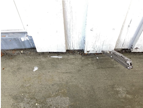
Spedt råte i kledning
