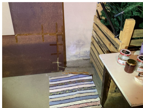
Saltutslag på innvendig vegg
