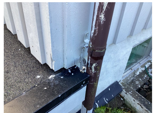
Spedt råte i kledning
