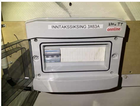
Inntaksikring 3X 63 Amp
