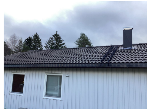
Taket har ikke snøfangere
