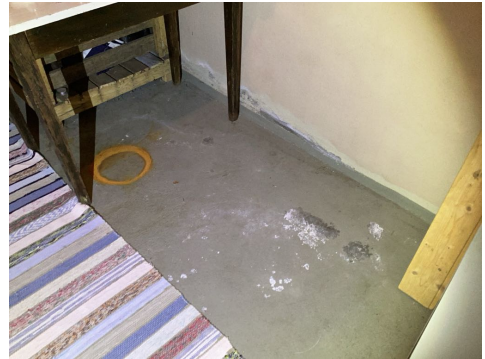
Saltutslag på gulv
