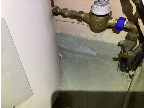
Saltutslag på vegg
