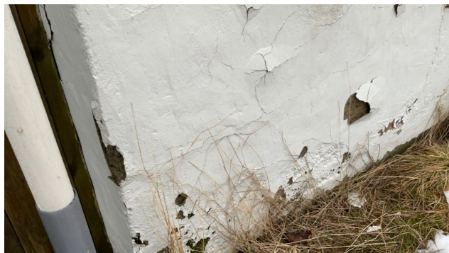
Parti av avflasset puss og løs puss.
