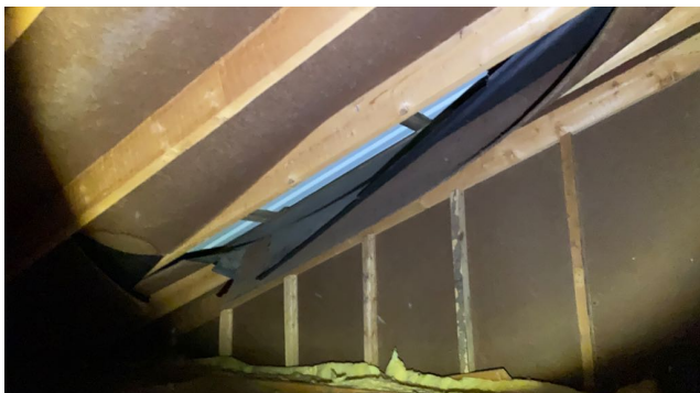
Utsnitt av undertak som har løsnet - underside av tekking eksponert.
