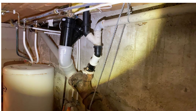
Utsnitt av avløpsrør i kjeller.
