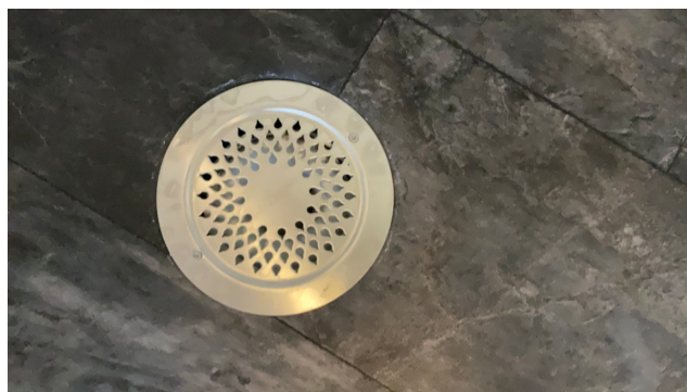
Slukrist fastskrudd slik at det ikke var mulig å se sluken.
