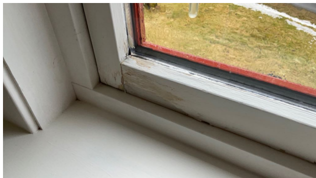
Kondensmerke på vindu.
