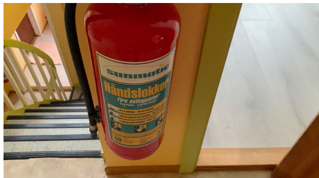
Brannslukker på 2. etasje.
