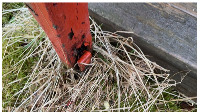
Utsnitt av råteskadd del.
