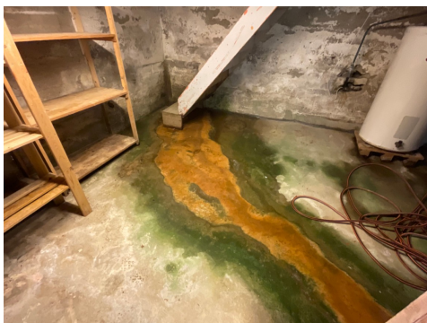
Utsnitt av forhold vedr. vanninntrenging i kjellerrom.
