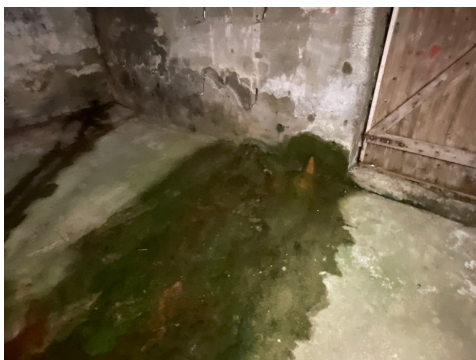
Utsnitt av forhold vedr. vanninntrenging i kjellerrom.
