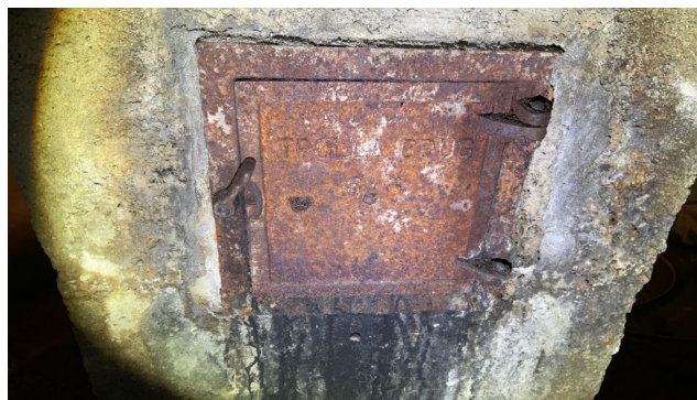
Sotluke i kjeller - ikke mulig å åpne.
