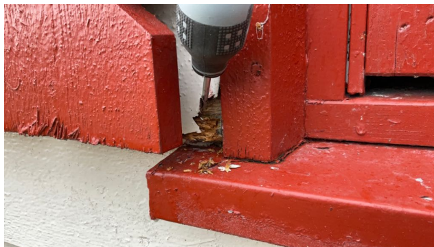
Utsnitt av panel med råte.
