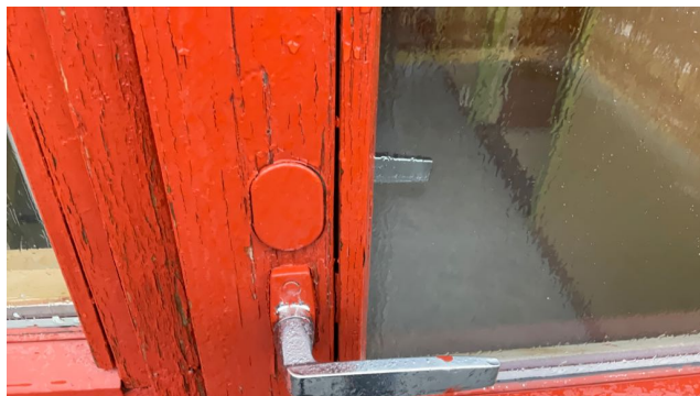
Sprekker i treverk.
