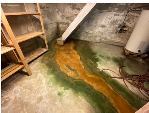
Utsnitt av parti med vanninntrenging i kjellerrom.
