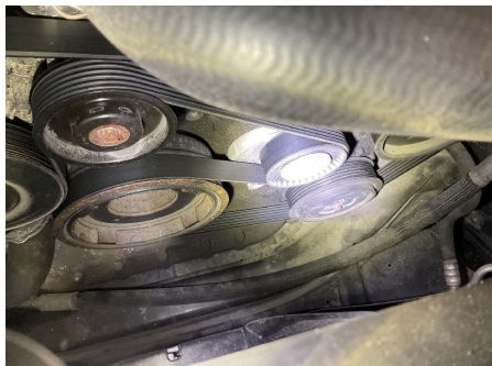
1. Utvendig tilstand motor
