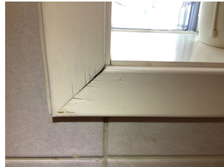
Karmlist er oppsprukket som følge av fuktbelastning.
