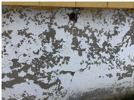
Utvendige skråriss og løsnet maling.
