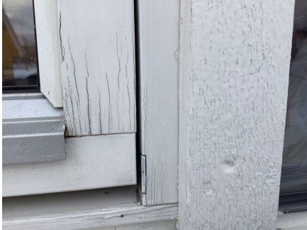
Eksempel på værslitt vindu.
