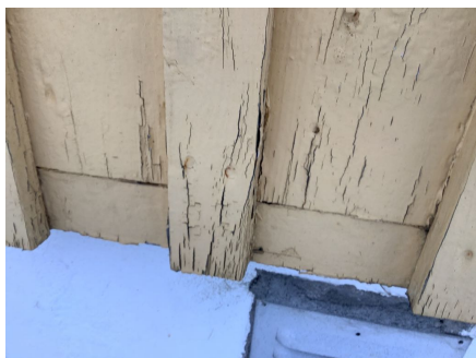
Eksempel på værslitt bordkledning.
