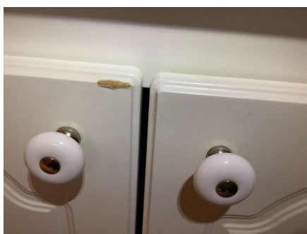
Eksempel på svellskader på innredning.
