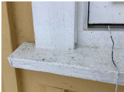
Omramming rundt vindu er ført helt ned på vannbrett.
