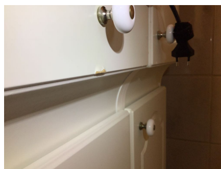
Eksempel på svellskader på innredning.
