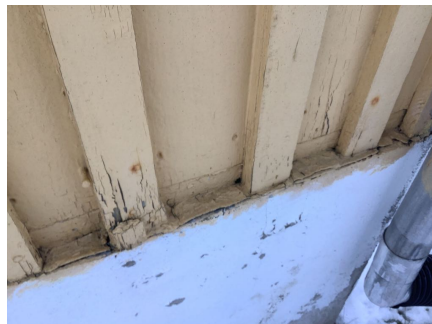
Bordkledning er ført helt ned på grunnmur, og dette har ført til spredte råteskader.
