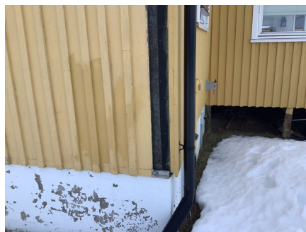
Det mangler kledningsbord mot hjørne.
