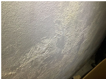
Eksempel på saltutslag på grunnmur.
