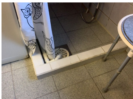
Flislagt sokkel forhindrer eventuelt lekkasjevann å renne til sluk.
