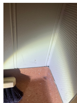
Ikke tett utførelse av belegg opp på vegg.
