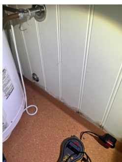
Fuktmåling gav ingen utslag på fukt.
