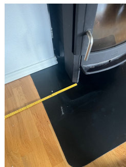
For kort avstand fra åpning til brennbart materiale.
