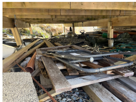
Søyler og drager under bjelkelag er svært skjev.
