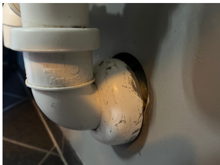
Ikke tett vegg under utslagsvask.
