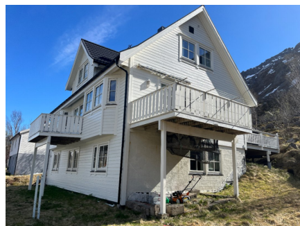
Mur av lettklinkerblokker på bakken kan gi uheldig vannansamling med fare for skader på fundamenter.
