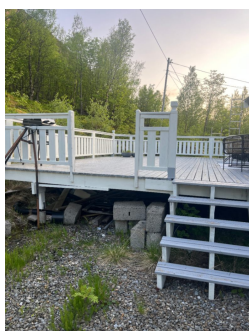
Del av rekkverk mangler på veranda.
