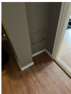
Sotluke for nært brennbart materiale.
