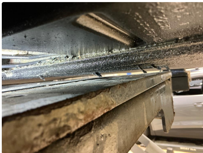
2.1 Sår i plate under batterikasse - ok
