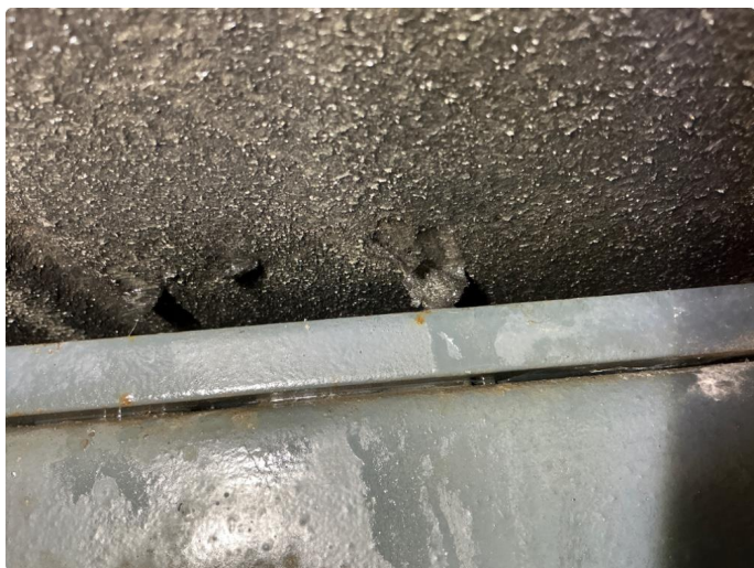
2.1 Sår i plate under batterikasse - ok
