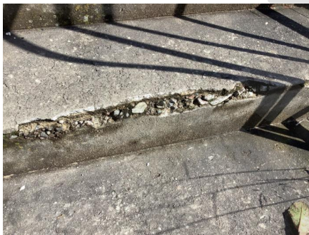
Skadet trinn i trapp.
