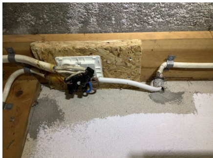
Manglende deksel og klippet kabel.
