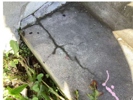
Sprekkdannelse i trapp.
