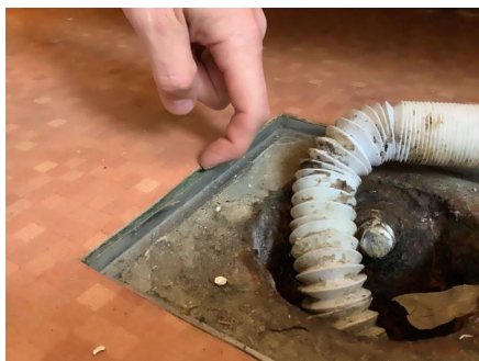
Utett overgang mellom vinylbelegg og sluk.
