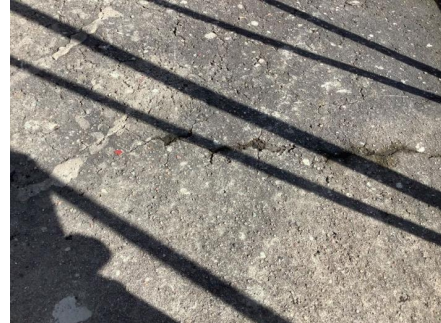
Sprekkdannelse i dekket.
