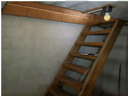
Det er ikke montert rekkverk eller håndløper.
