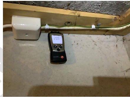
Skadelig fuktinnhold i treverk.
