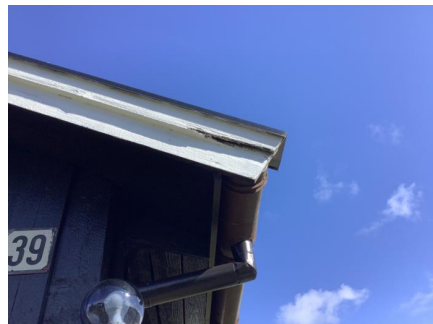
Vindski med råteskader.
