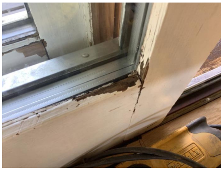
Slitasje på skyvebalkongdør.
