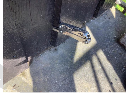
Eksempel på råteskadet kledningsbord.
