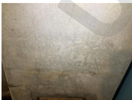
Eksempel på riss i pipe.
