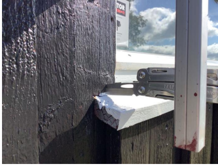
Omramming er ført helt ned til vannbrett, og dette har ført til råteskader.
