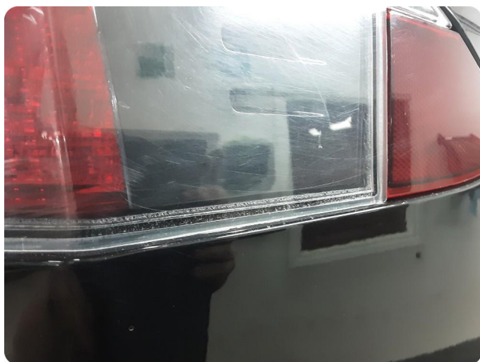
4.1 Krakelering i plast
