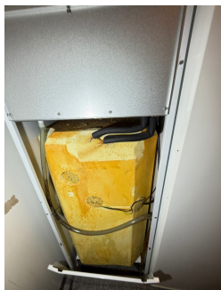
Oversikt bereder i ventilasjonsskapet
