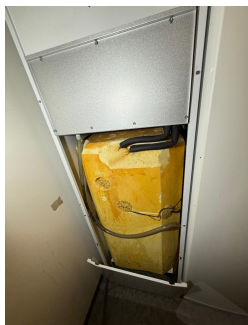
Ventilasjonsaggregat med integrert vvbereider
