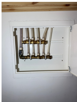
Oversikt rør i rør skap. Montert i bod/teknisk rom
