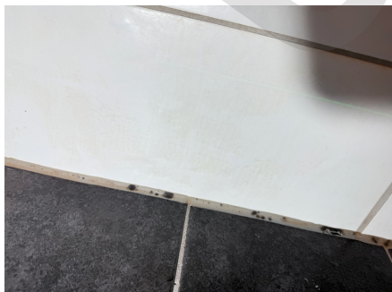
Svertesopp i silikonfuge i overgang mellom gulv og vegg
