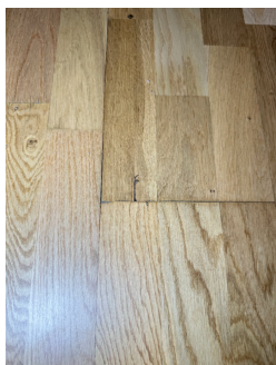
Sprekke/hakk i parkett i gang ved stue/kjøkken.
