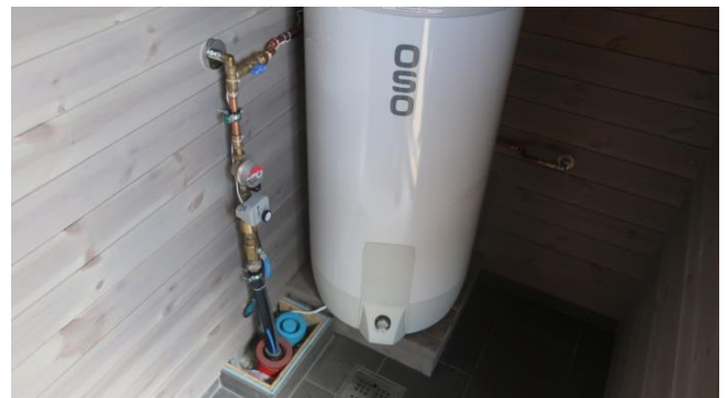
Vanninntak, stoppekran, vannmåler og vannstopp i teknisk rom.
