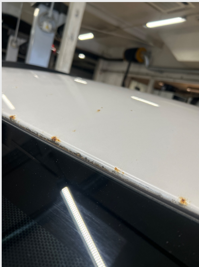
2.10 Rust på tak
