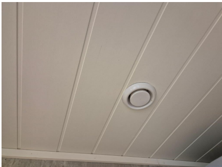
Ventil i innvendig tak.
