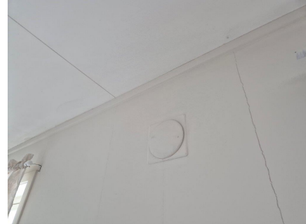
Veggentil i kjøkken (stue).
