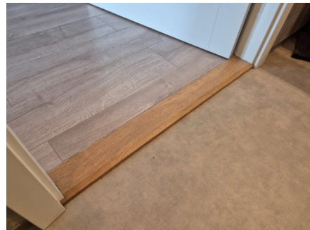
Dørterskel er tett (dør mangler tilluftsspalte).
