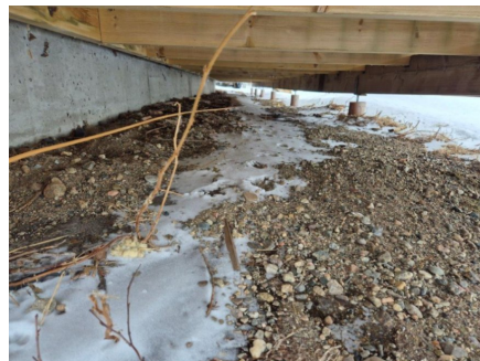
Bilde tatt under veranda. Terreng ser ut til å ha fall utfra grunnmur.
