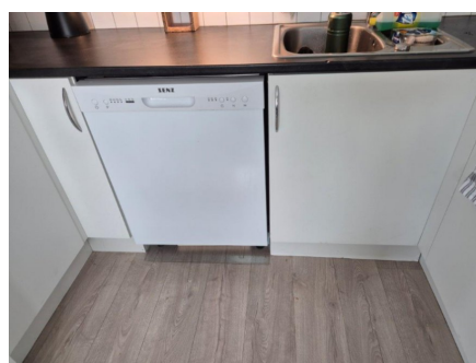
Kjøkkenbenk, synlig hakk i benkeplate ved kum.
