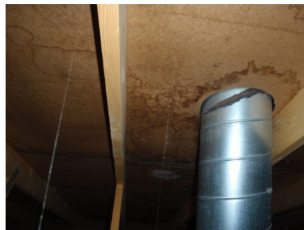
Bildet tatt i mars-19. Fuktmerker rundt pipe.
