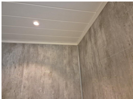
Himlingspanel/himlingsplankett i innvendig tak.
