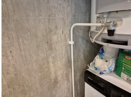
Røropplegg for varmvannsbereider (2021).
