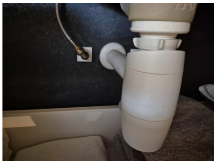
Røropplegg i servantskap.
