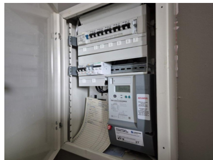
Sikringskap med automatsikringer i bod .
