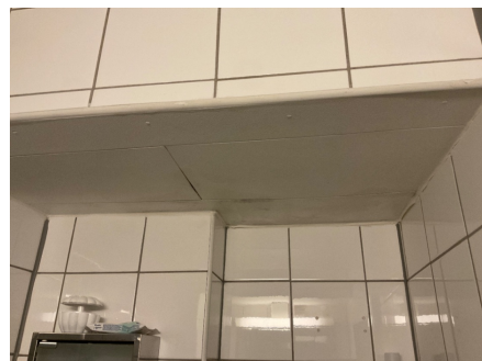
Fuktskader etter lekkasje fra berederen i taket på badet.
