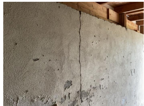
sprekker i mur ved inngang kjeller
