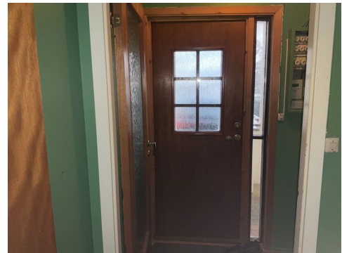
slitt ytterdør, behov for vedlikehold
