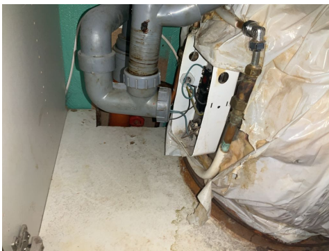
fuktskader under oppvaskkum rundt varmtvannstank
