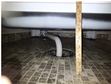
fall til sluk som ligger under kabinett
