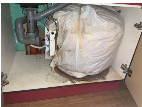
varmtvannstank mulige lekkasjer.
