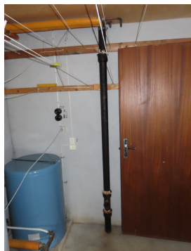
Støpejernsrør som avløpsrør. Merk alder og naturlige utskiftingbehov.
