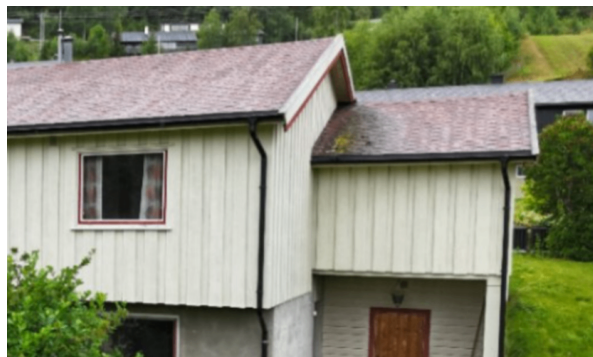
Mosevekst i tekkingen på leside av garasjetak.
