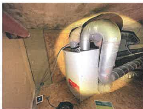
Ventilasjonsunit på blindrom over himling på baderom
