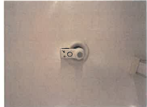
Avtrekksvifte i himling.
