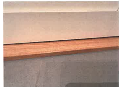
Spalte mellom dørbblad og dørterskel.
