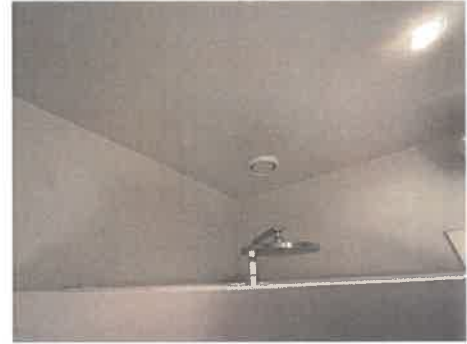
Avtreksventil i himling.
