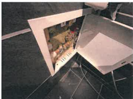
Stengeventil bak luke på bad/vaskerom.
