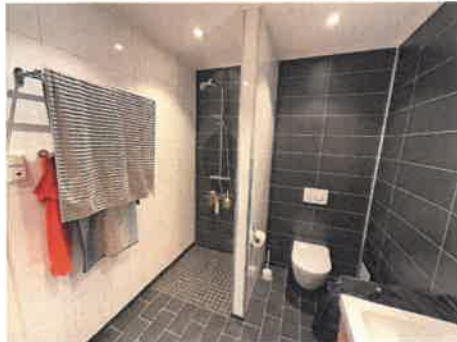
Dusjarmatur på vegg.
