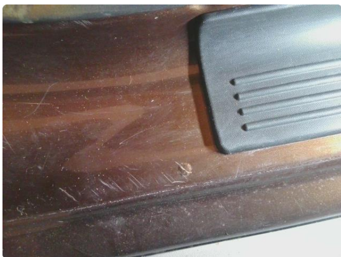
2.18 Rust på døråpning h.s
