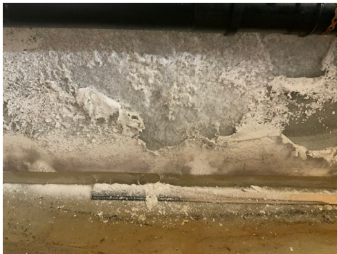
Saltutslag i nedre del av ytterveggen
