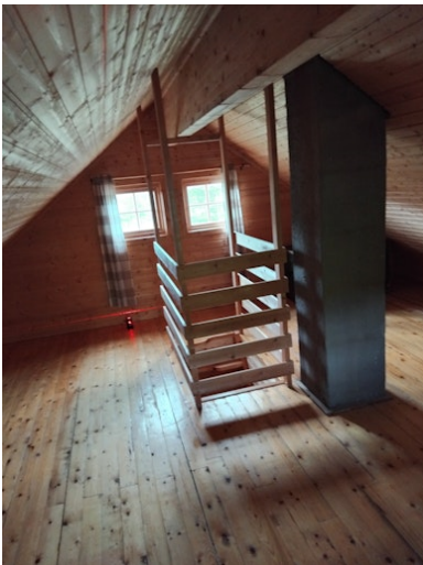
Pusset pipe på loft.
