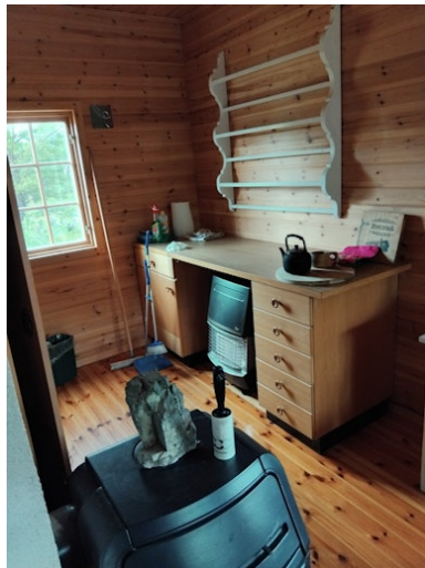
Avstand fra ovn til brennbart materiale er for liten.
