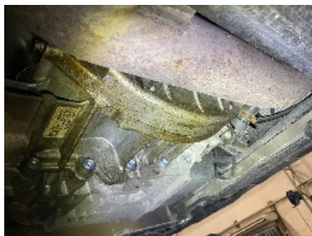
8. Utvendig tilstand motor
