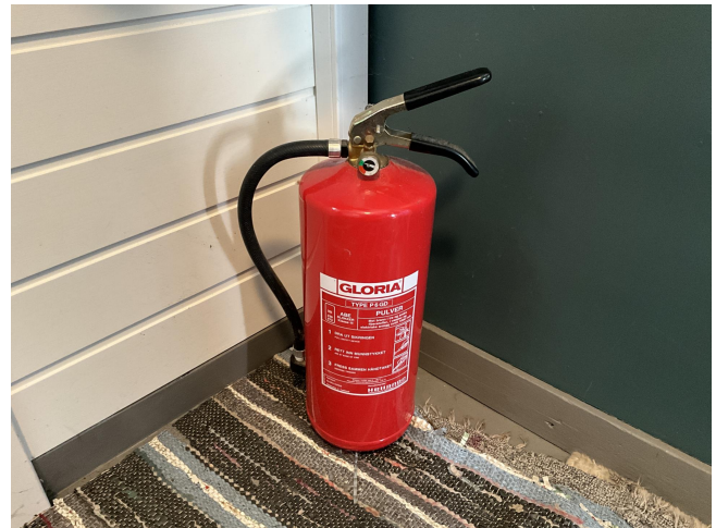
Brannslukkerapparat. Det er ikke utvist årstall på brannslukker.
