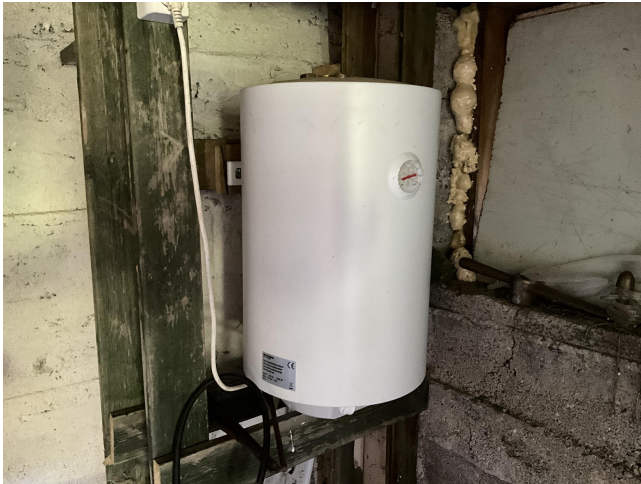
30 liter varmtvannsbereder i kjelleren.
