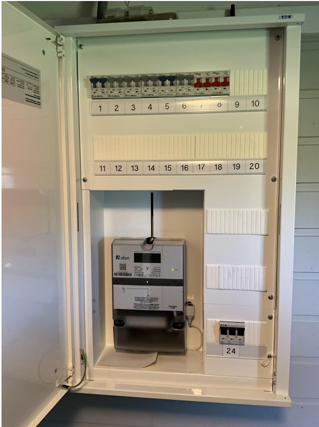
Sikringsskap med automatsikringer.
