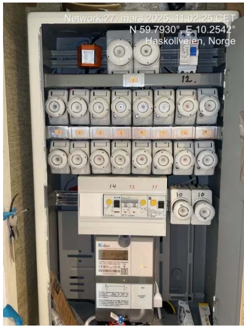
Sikringskap i gang
