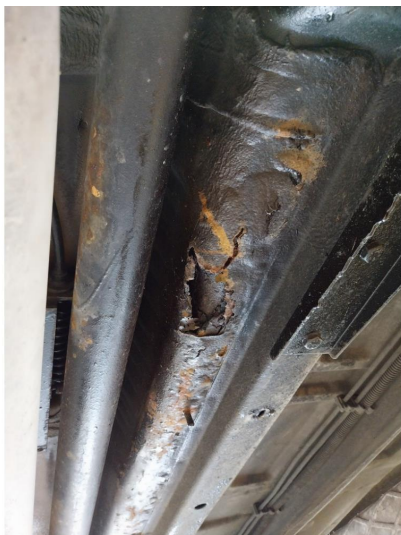
1.12 Rusthull ved gulvet under bil
