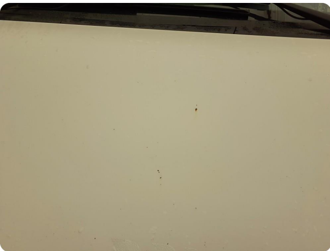
3.1 Generelt mye bruksslitasje Inkluderer riper, rust, bulker, skader
