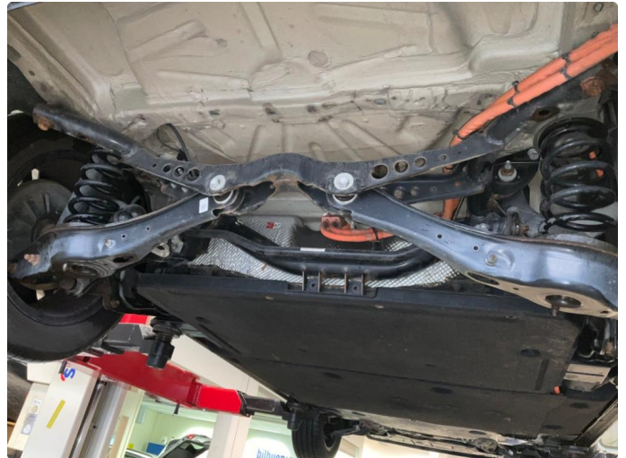
1.1 Normal/ubetydelig korrosjon vognbunn/travers iht alder og kjørelengde.
