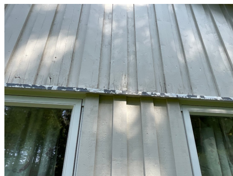
Defekter i kledning over vindu.
