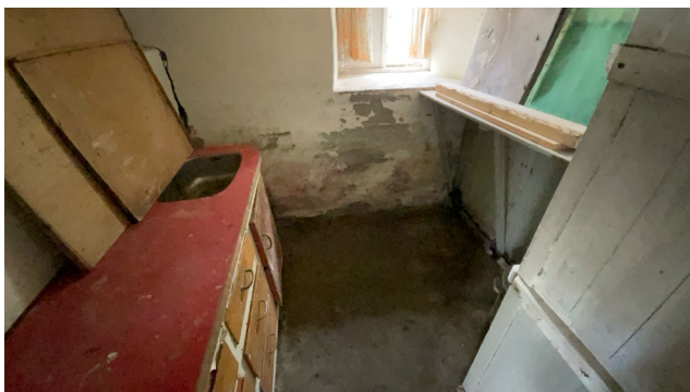
Fukt i vegg/ gulv i kjeller.
