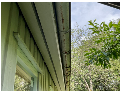
Takrenne har rustet hull i bunn
