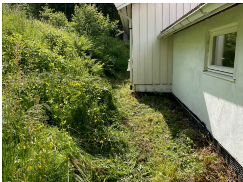
Vegg bak boder i murt og pusset utførelse.
