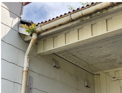
Takrenne og nedløpsrør rustet. Nedløp grodd tett.
