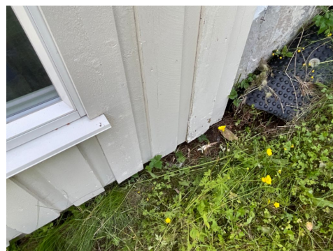
Kledning er nær bakken.
