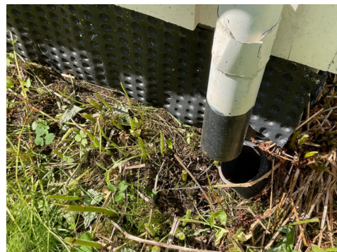
Nedløp ikke tilkoblet rør i bakken.
